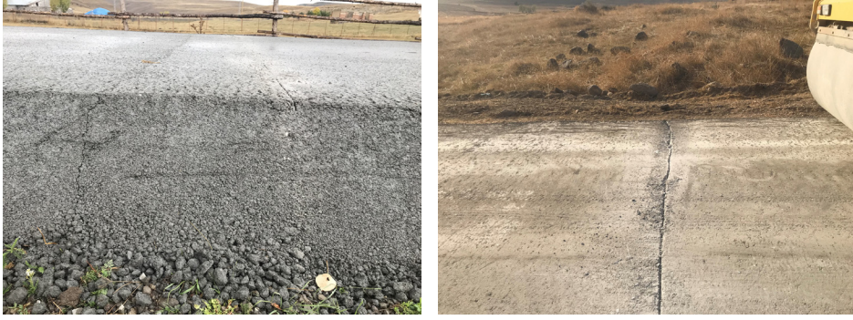
Şekil 7. Uygun olmayan kontrollü derz örnekleri
