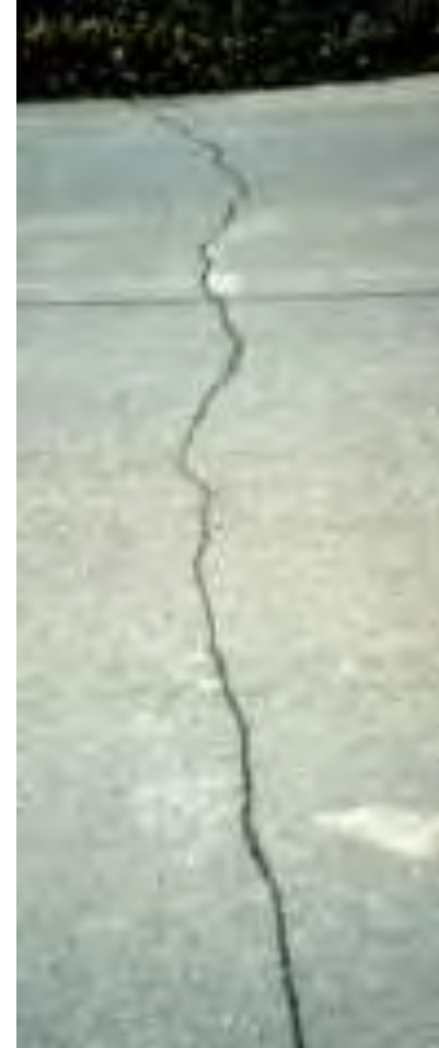
10 senelik, Doldurulmuş çatlak
