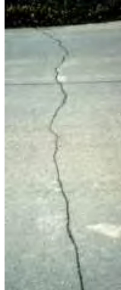
10 senelik, Doldurulmuş çatlak
