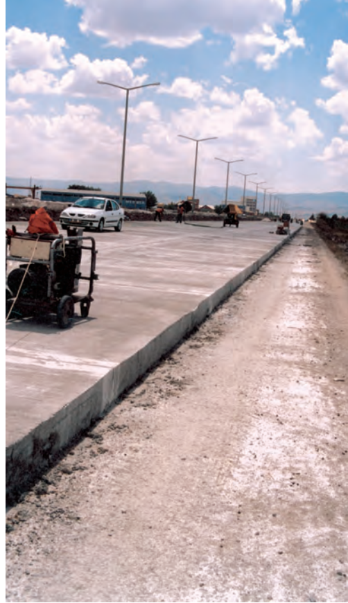
Şekil 49. Düşük hale gelmiş banket
