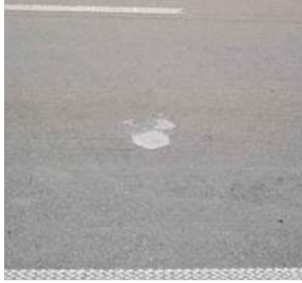
ŞEKİL 4 – PÇ HARCİ İLE ONARILMIŞ SÖKÜLME
