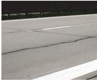
ŞEKİL 11 – GENİŞLETİLİP DOLDURULMUŞ ÇATLAK
