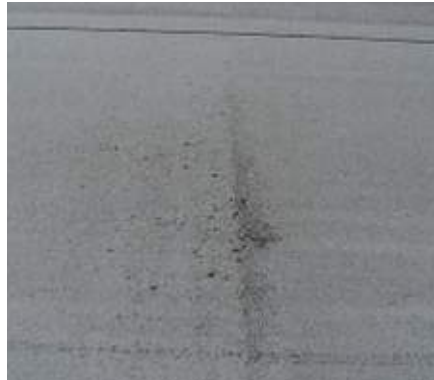
ŞEKİL 6 – YOL YÜZEYİNDE MALZEME KAYIPLARI
