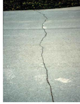
10 yıllık, Doldurulmuş Çatlak
